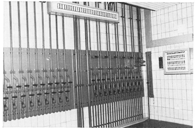
Bild 5 Verteilertafel, Anzeigetableau und Schalttafel
