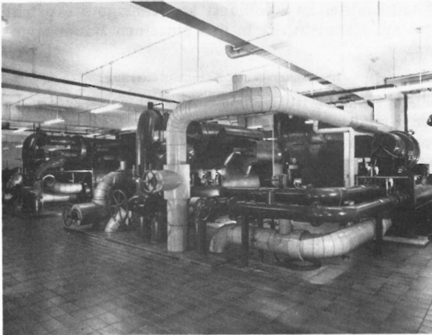
Bild 6 Kältezentrale mit vier Turbokältemaschinen
